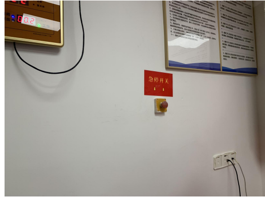
紧急止动开关（控制室操作台）
