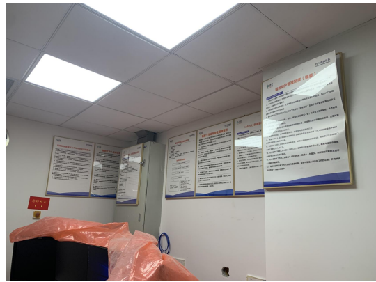
直加机房控制室
