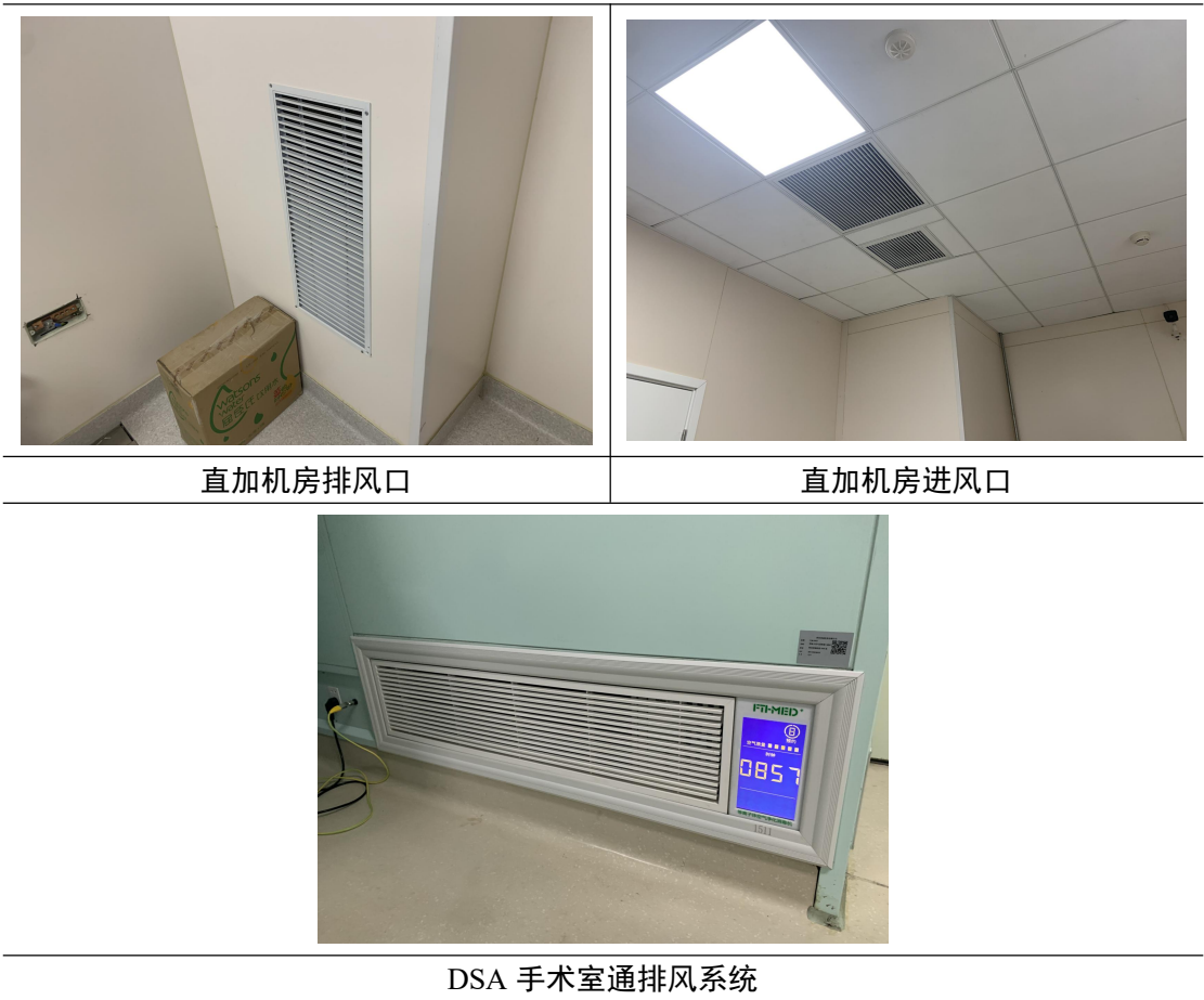
图 3-6 本项目射线装置机房通排风系统
