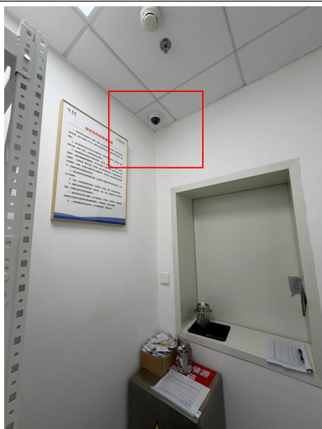
放射性药物储源库监控摄像头
