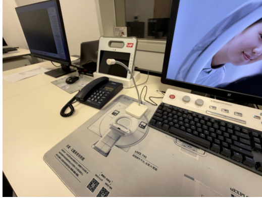
PET 控制室对讲装置
