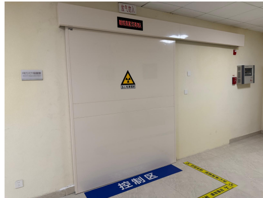
PET/CT 检查室防护门、工作状态指示灯、 电离辐射警告标志
