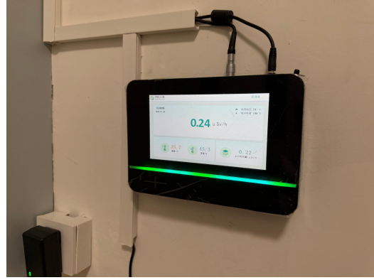
固定式剂量报警仪（衰变池间内）
